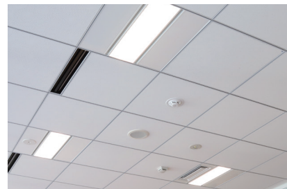
システム天井専用設備機器
