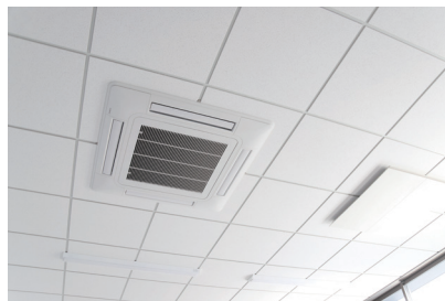
システム天井化した一般設備更新例
